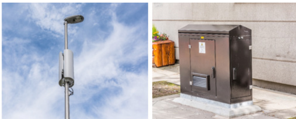
图6：小型基站天线系统和街边机柜
