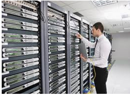
Figura 19: Data Center Integrado del Gobierno
