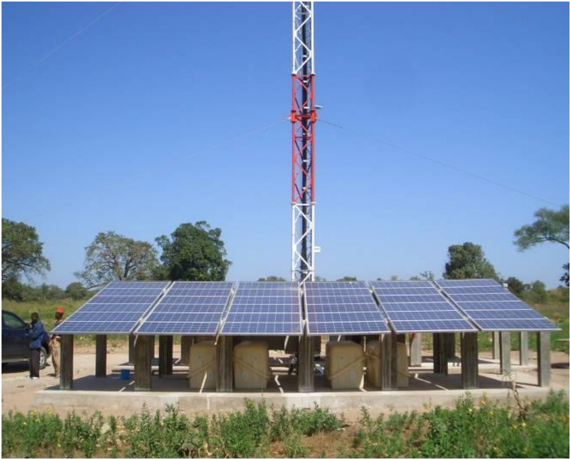
图12：塞内加尔移动网络站点的太阳能站
