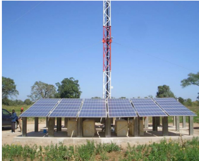
Figure 12: Station solaire d'un site de réseau mobile – Déploiement au Sénégal
