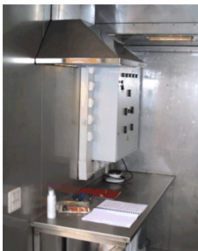
Poste de travail avec système d'épuration d'air
