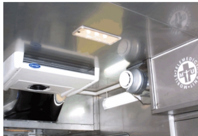
Système de climatisation
