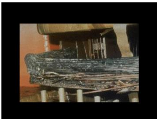
因1989年3月13日太阳活动烧坏的配电网变压器
