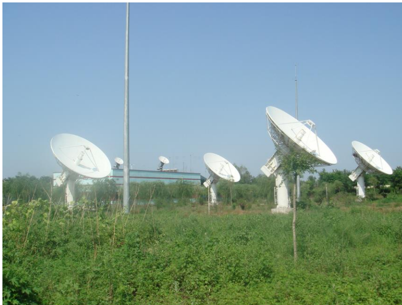
第二套系统的四副直径7.3 m天线 和参考源发射天线（屋顶上）
