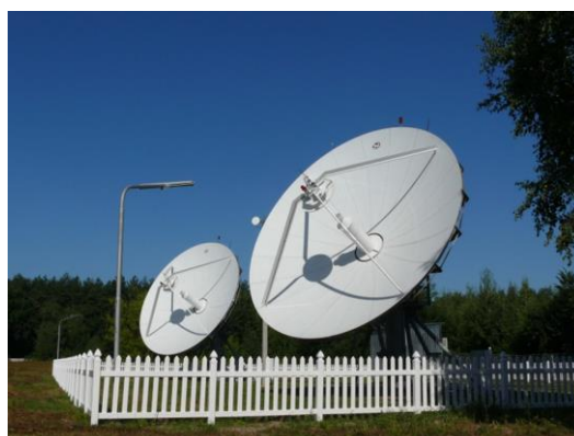
Sistemas de antenas de la estación de comprobación técnica del UCFR
