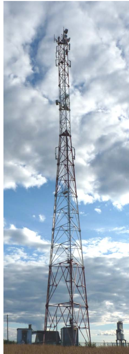
Общий вид сайта BTS энергопотребление около 5 кВт
