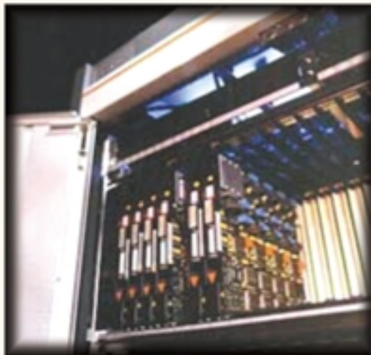
Fig. 5.5 Armoire d'accès ADSL
